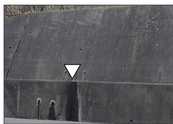
地下水の流出
