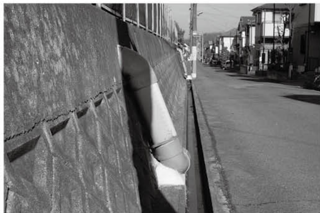
排水管（近つ飛鳥小学校）
