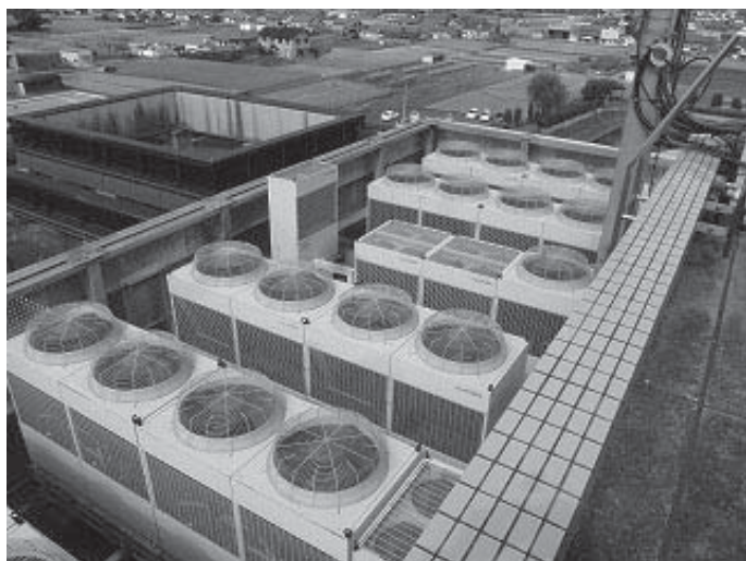
役場庁舎屋上空調機器
