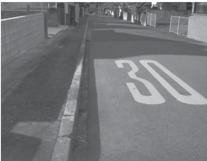
段差のある歩道
