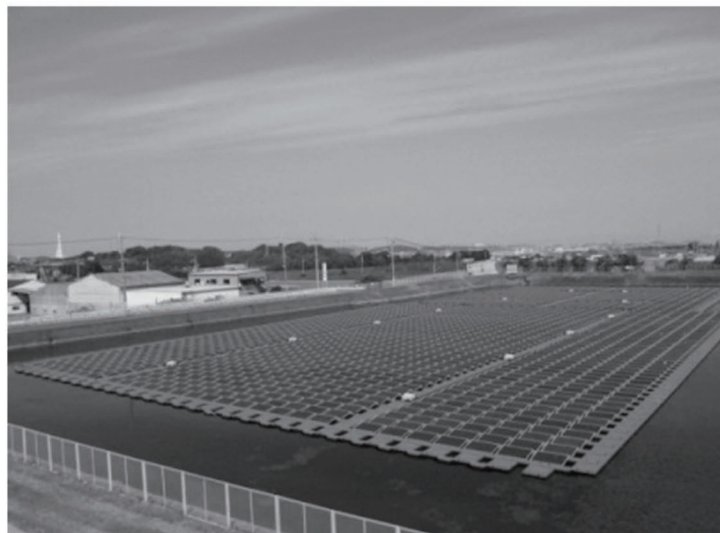
今堂池水上太陽光発電設備
