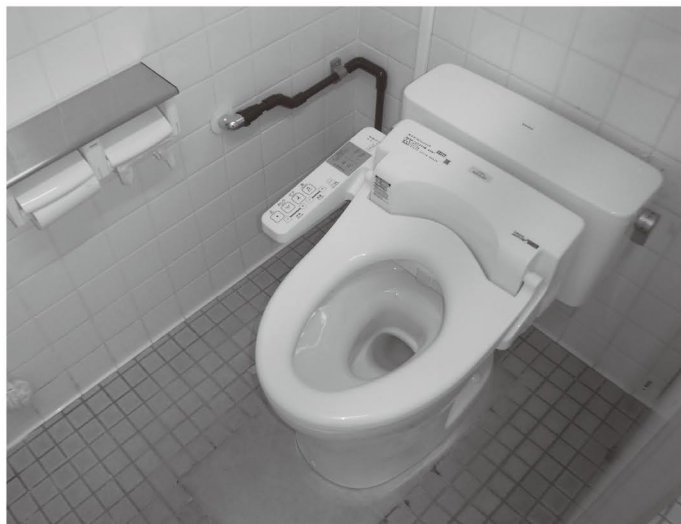
改修された洗浄機能付き 洋式トイレ
