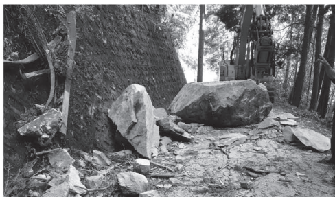
落石により通行止めとなった町道(持尾地区)
