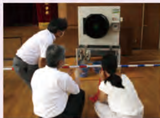
▲小・中学校の体育館に設置された移動式クーラー
