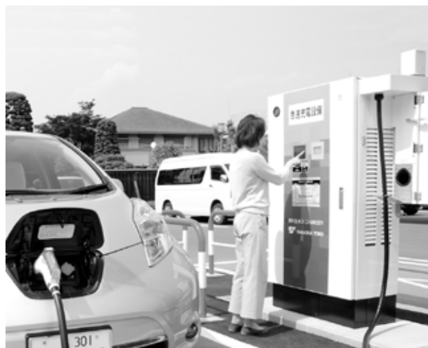
▲電気自動車の普及促進策として、道の駅かなんに充電設備の設置を。
