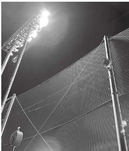
総合グラウンドの照明器具の増設は、できないか？
